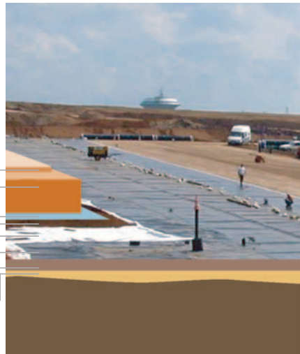
Die flacheren Bereiche des Autobahnkreuzes Leverkusen-West erhalten eine Kombinationsabdichtung ähnlich der Abdichtung im Bereich Dhünnaue-Mitte.
